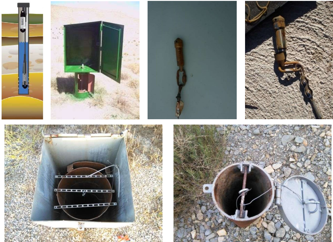
Figura 20: En la primera imagen se muestra el ejemplo de instalación facilitado por la empresa suministradora de Diver y Baro Diver. En el resto de imágenes se observan ejemplos de las instalaciones en la zona de trabajo.
